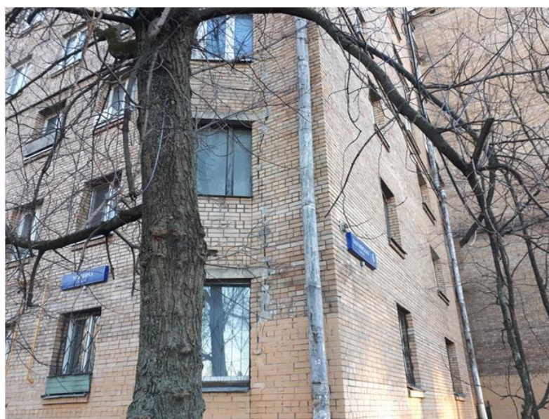
Рисунок 2. Трещина на доме по адресу ул. Балтийская д. 6
