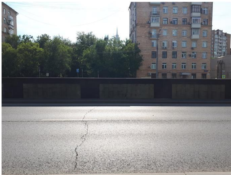
Рисунок 1. Трещина на автостраде рядом с Алабяно-Балтийским тоннелем
